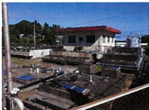
4.芦辺浄水場外観
